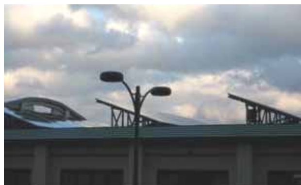
(図表 16)ラ・フランス温泉館の太陽光発電システム
